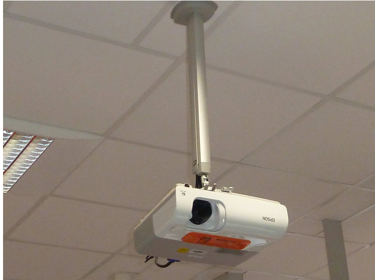
Der „GMG-Weihnachts-Wunsch“: Jede Klassenzimmerdecke mit einem fest installierten Beamer – wie hier im Chemiesaal C3
